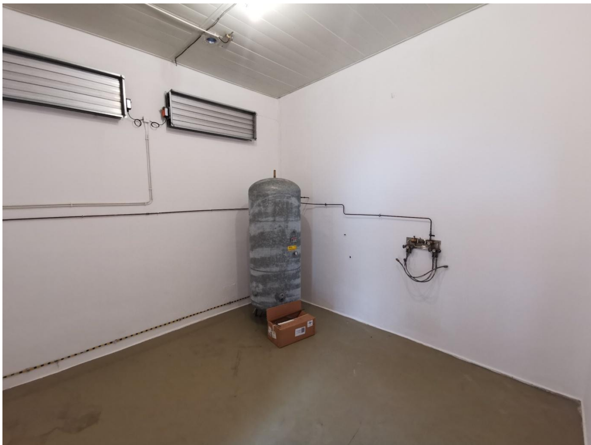
Rysunek 8 Pomieszczenie magazynu butli wodorowych (M08) - widok na zbiornik wodoru
