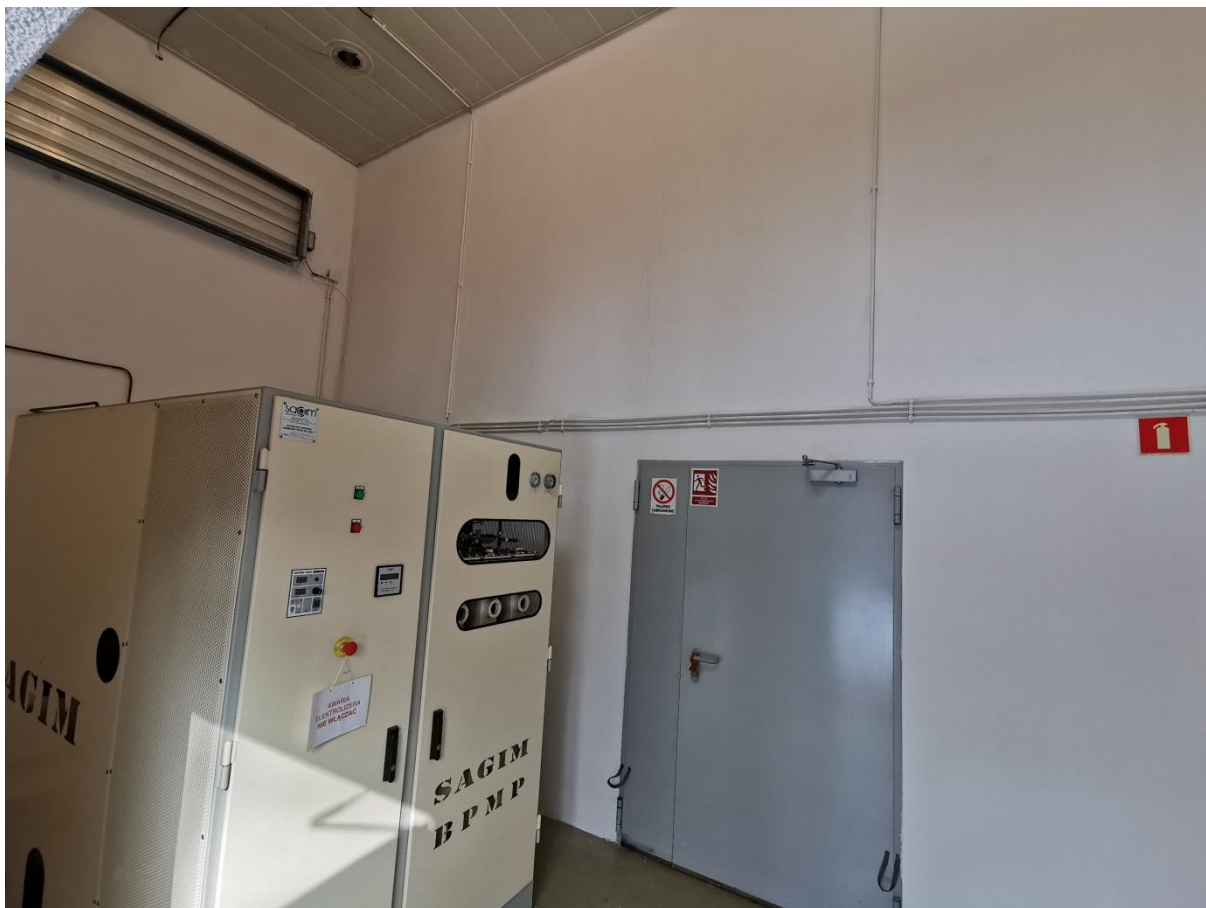
Rysunek 6 Pomieszczenie magazynu butli wodorowych (M07)
