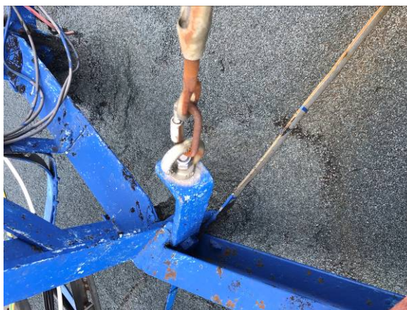
Skorodowane stężenia ramy łukowej na rotundzie
