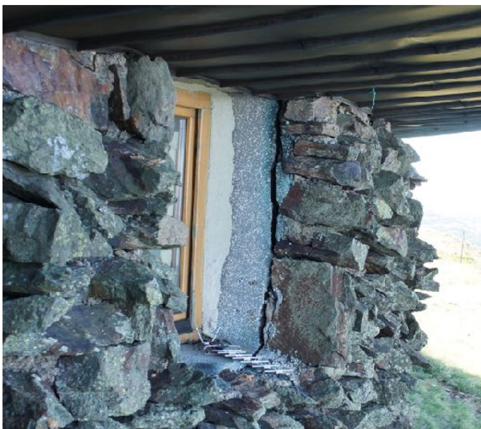
Fot. nr 8. Znaczne odspojenia elewacji od ściany zewnętrznej
