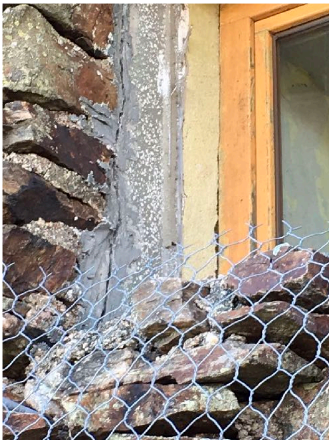
Fot. nr 7. Początki odspajania się wykładziny (elewacji) z kamieni od ściany zewnętrznej
