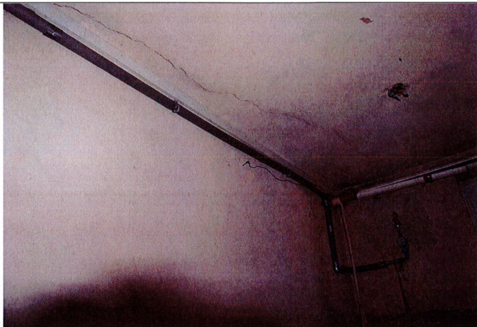
Nr 4. – Zarysowania stropu nad piwnicą
