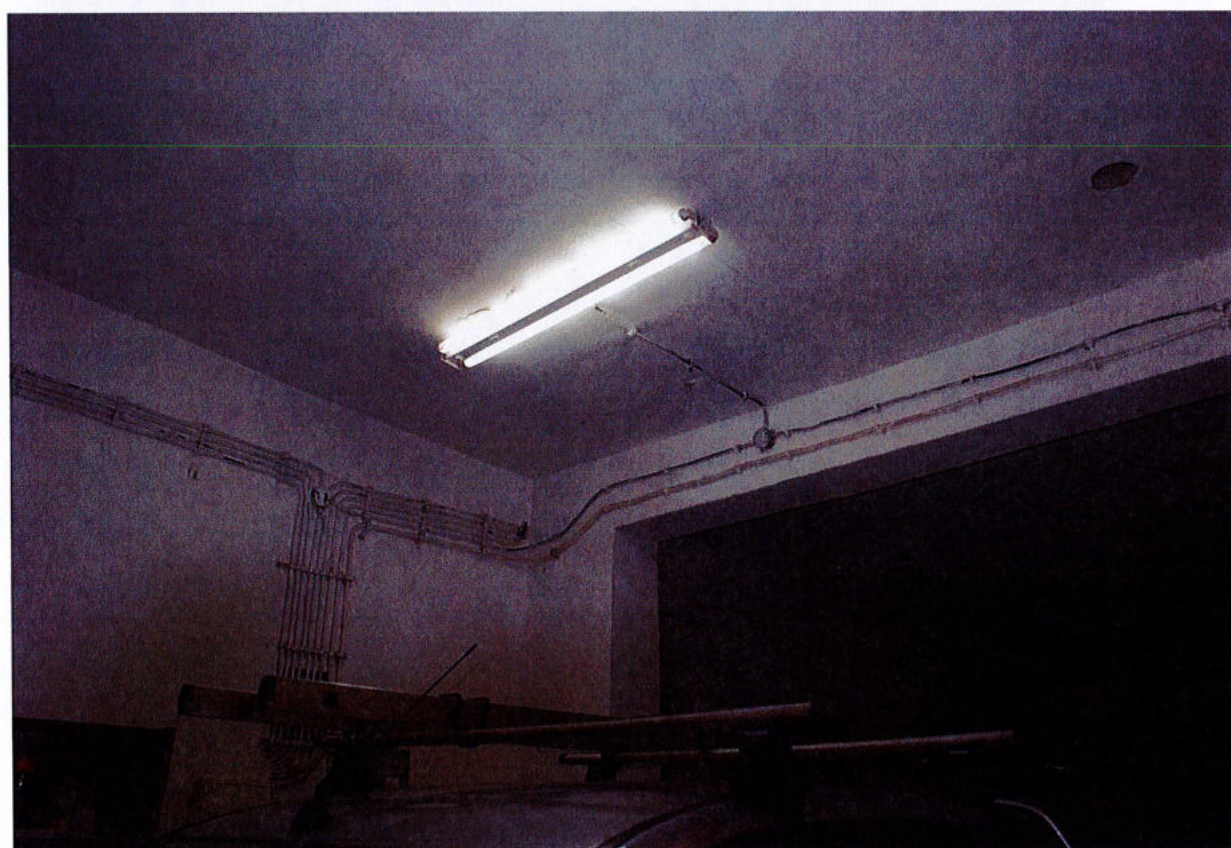
Nr 6. – „Klawiszowania” stropu WPS
