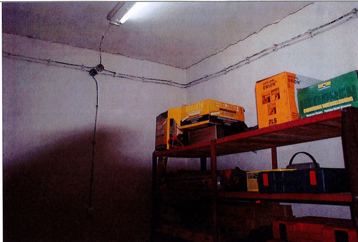
Nr 5. – Spękania podsufitowe ścianki działowej
