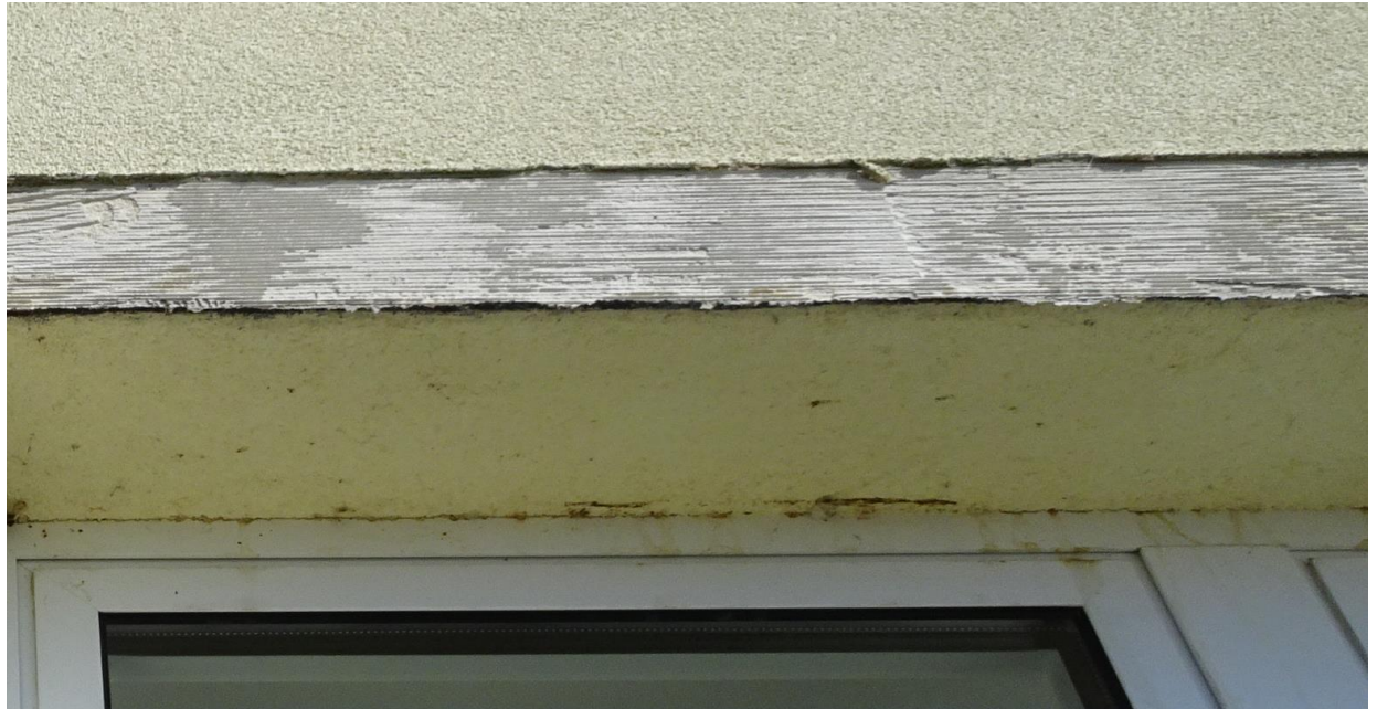
Rys. 12. Zarysowanie tynku w miejscu łączenia z ramą okienną. Ślady przedostającej się wody widoczne na ramie okiennej.
