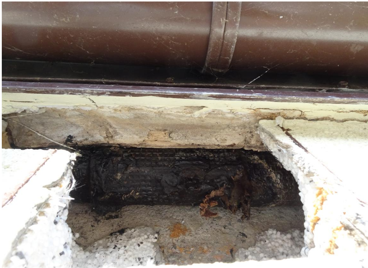
Rys. 8. Odkrywka przy opierzeniu na elewacji południowej. Koryto z papy termozgrzewalnej wypełnione wodą.
