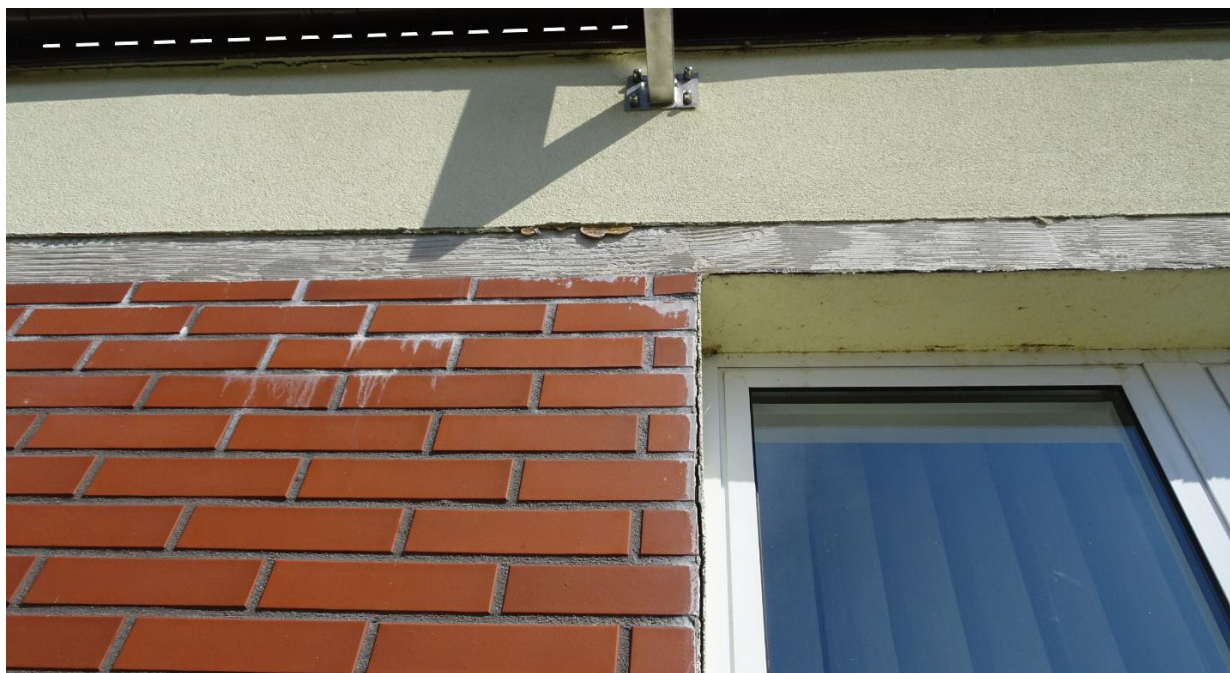
Rys. 10. Odspojenie dekoracyjnych listew styropianowych nad gzymszem okiennym. Rozwarstwienia na styku elewacji z obróbką blacharską.
