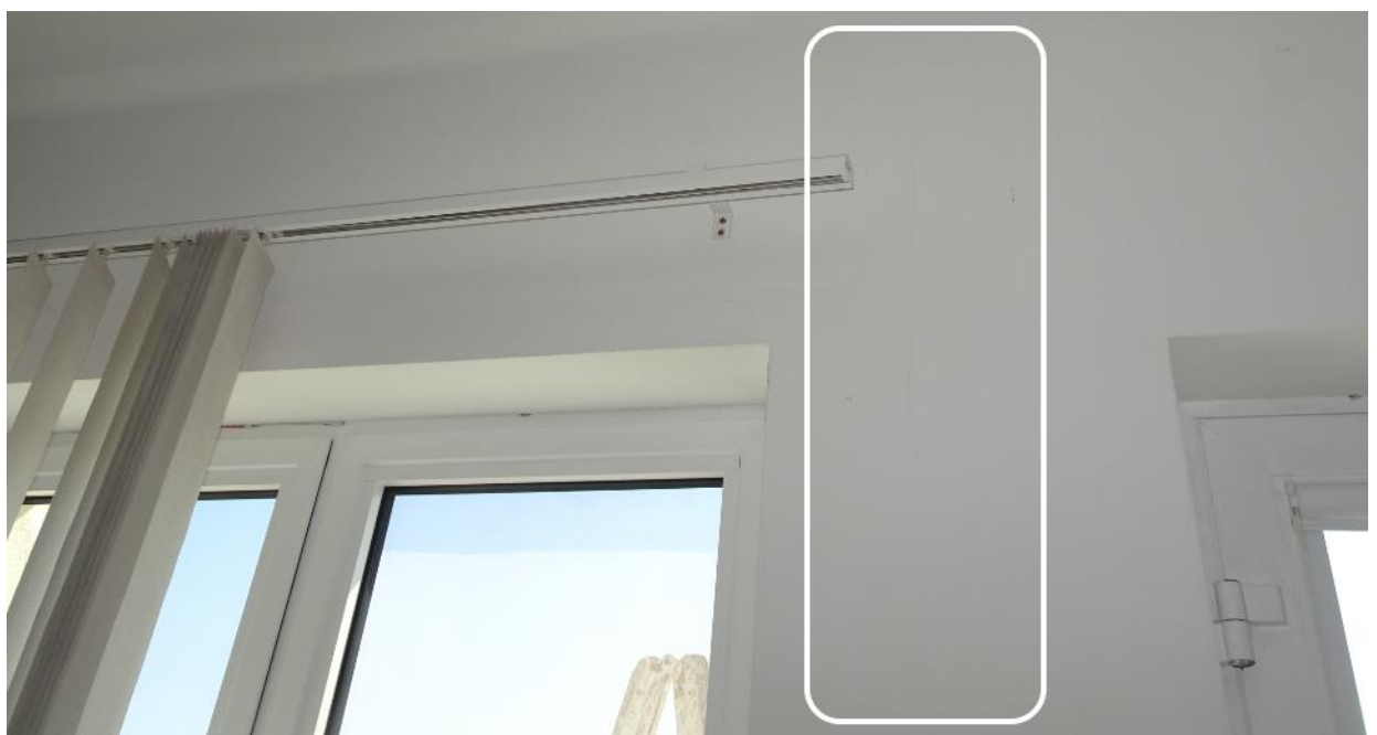
Rys. 16. Obszar zawilgocenia południowej ściany zewnętrznej.
