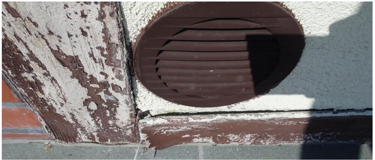
Rys. 14. Uszkodzenia dekoracyjnych listew styropianowych.
