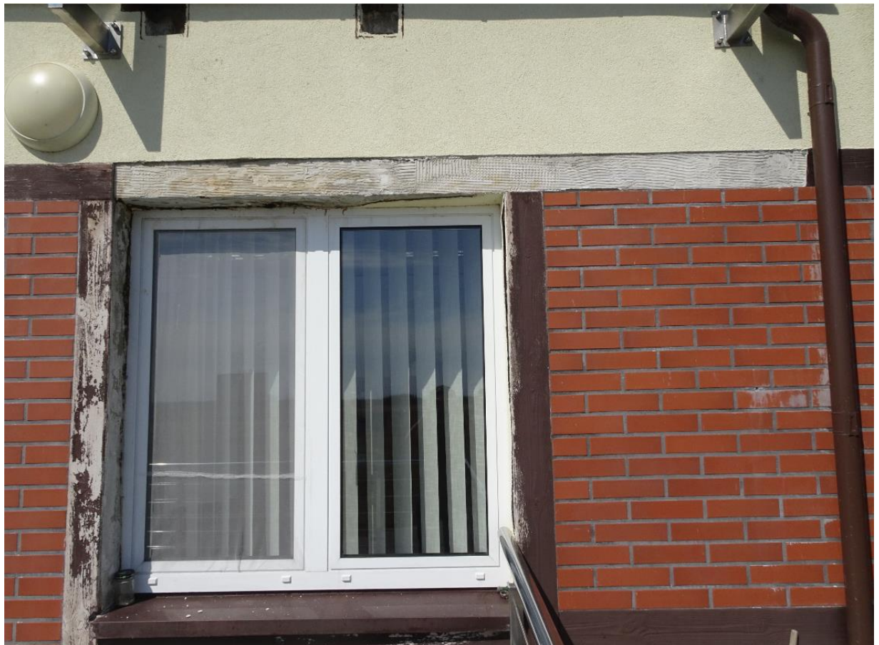
Rys. 7. Uszkodzenia elewacji od strony południowej.
