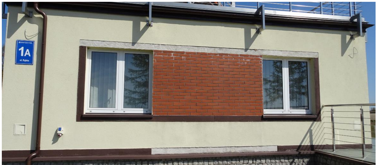
Rys. 15. Elewacja zachodnia. Oderwaniu uległy dekoracyjne listwy systemowe.
