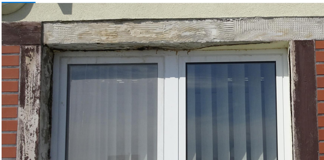
Rys. 9. Oderwaniu listwy dekoracyjnej oraz tynk na ościeżkach okna.
