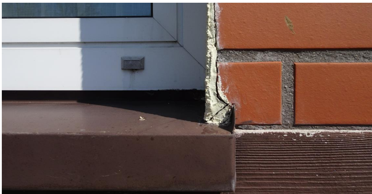
Rys. 11. Odspojenie tynku na ościeżach okiennych.
