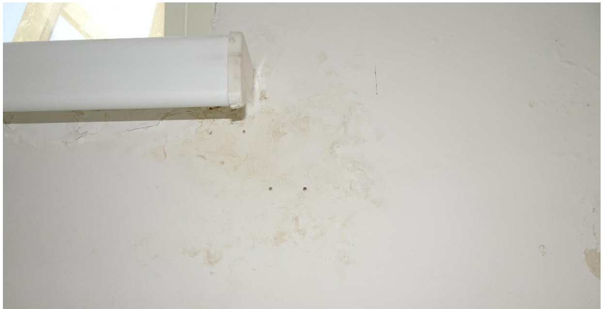
Rys. 17. Zawilgocenie narożnika przy parapecie. Ściana południowa zewnętrzna.
