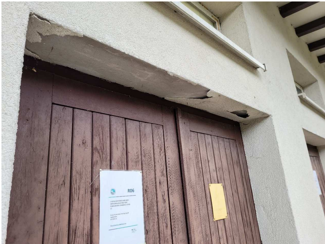
foto. nr 5 – widok (detal) na zwichrowaną drewnianą stolarkę drzwiową oraz odparzone tynki cienkowarstwowe
