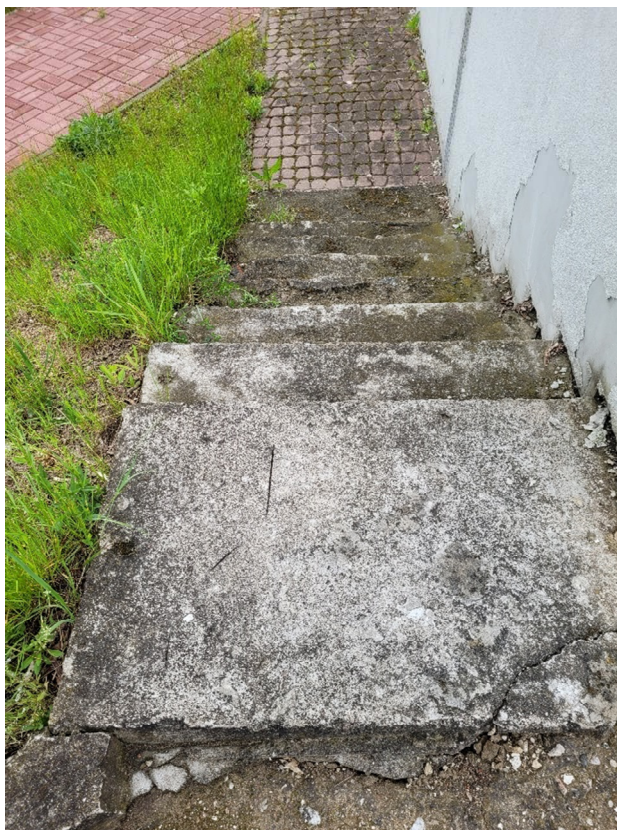
foto. nr 6 – widok (detal) spękany i odparzony bieg schodowy
