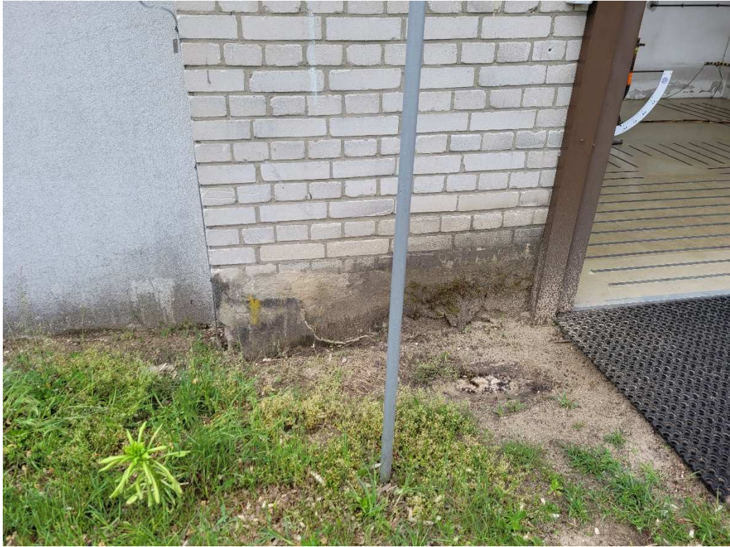
foto. nr 4 – widok (detal) na odparzone tynki cem. wap. cokołów
