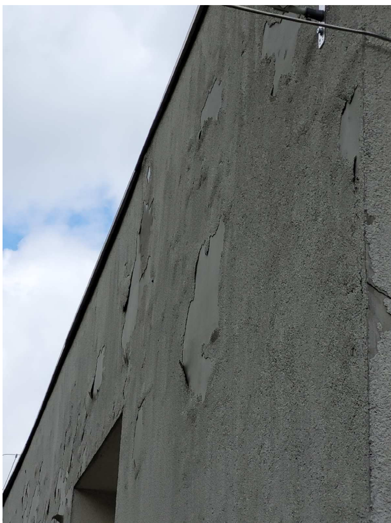
foto. nr 3 – widok (detal) na odparzone tynki cienkowarstwowe typu baranek
