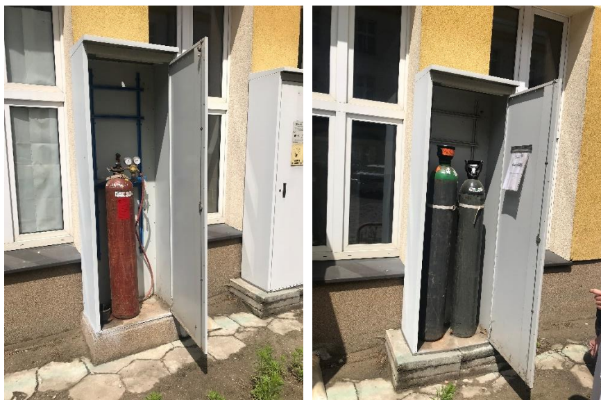
Lewa szafa z butlą podłączoną do instalacji
