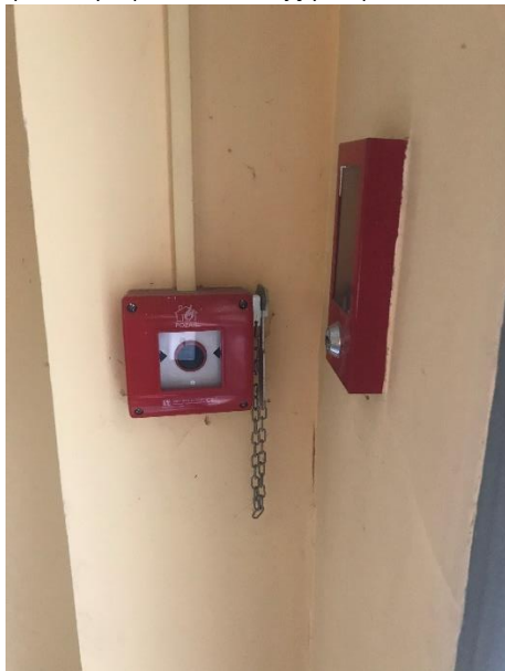
Przeciwpożarowy wyłącznik prądu
