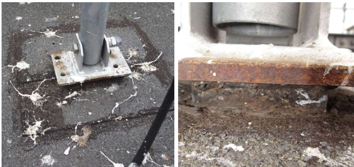
Rys. 25. Uszkodzenie izolacji przeciwwodnej w miejscu przejścia stalowej konstrukcji wsporczej.
