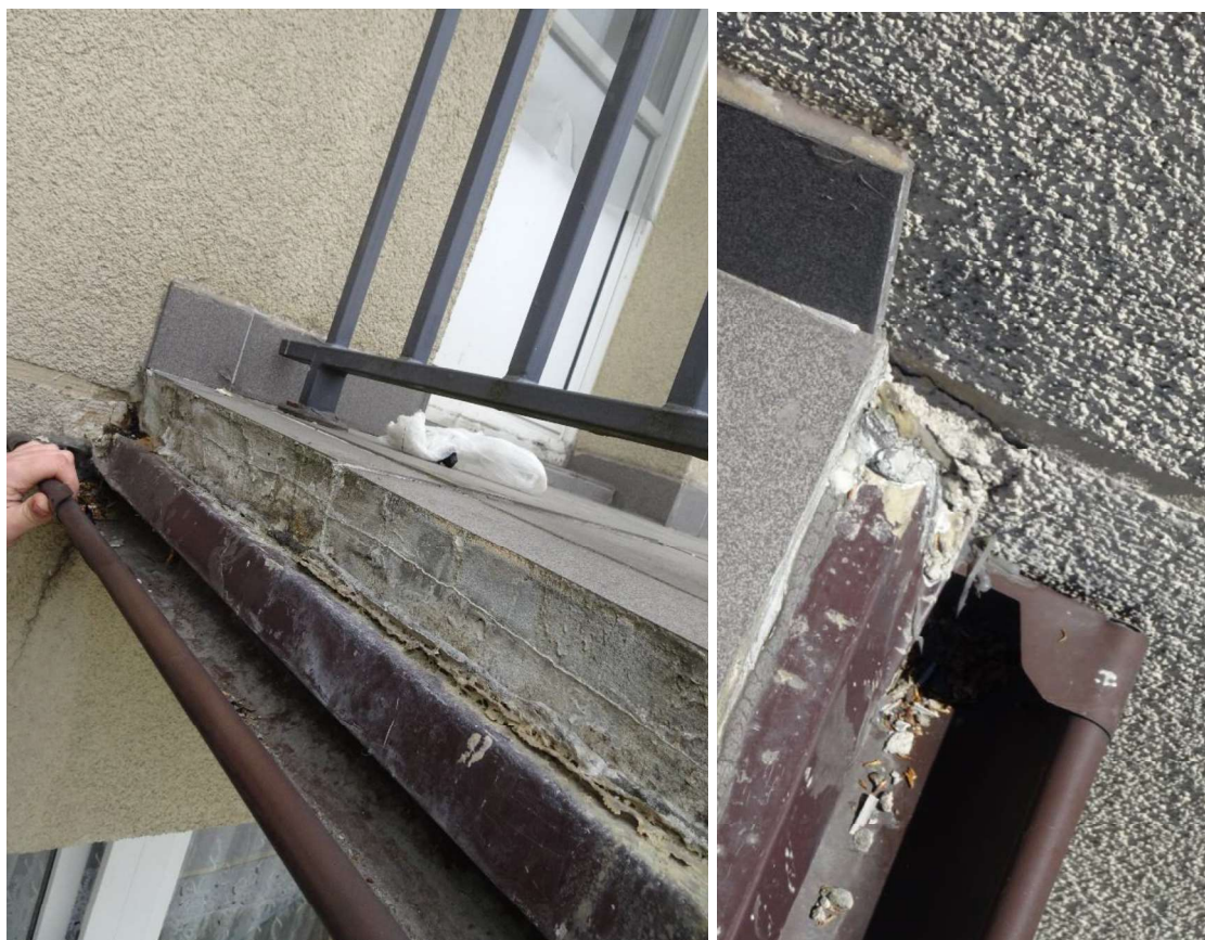
Rys. 10. Zarysowania tynku w miejscu przejścia obróbki blacharskiej przez elewację. Brak prawidłowego zakończenia obróbki blacharskiej. Odspojenie płytek na krawędzi balkonu.
