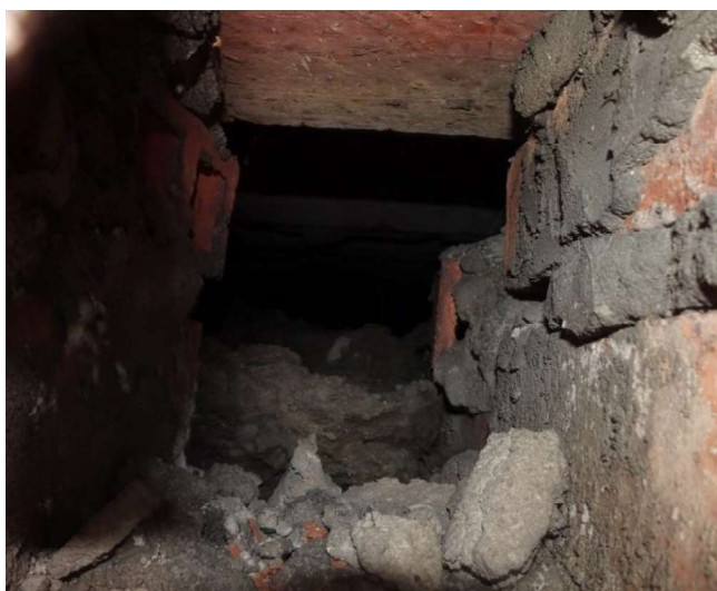
Rys. 27. Degradacja wełny mineralnej ułożonej na płycie stropowej ostatniej kondygnacji.
