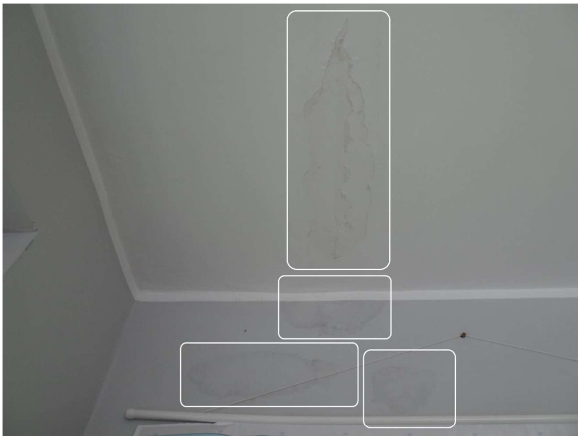
Rys. 21. Zawilgocenie stropu oraz ściany w pomieszczeniu obserwatora.
