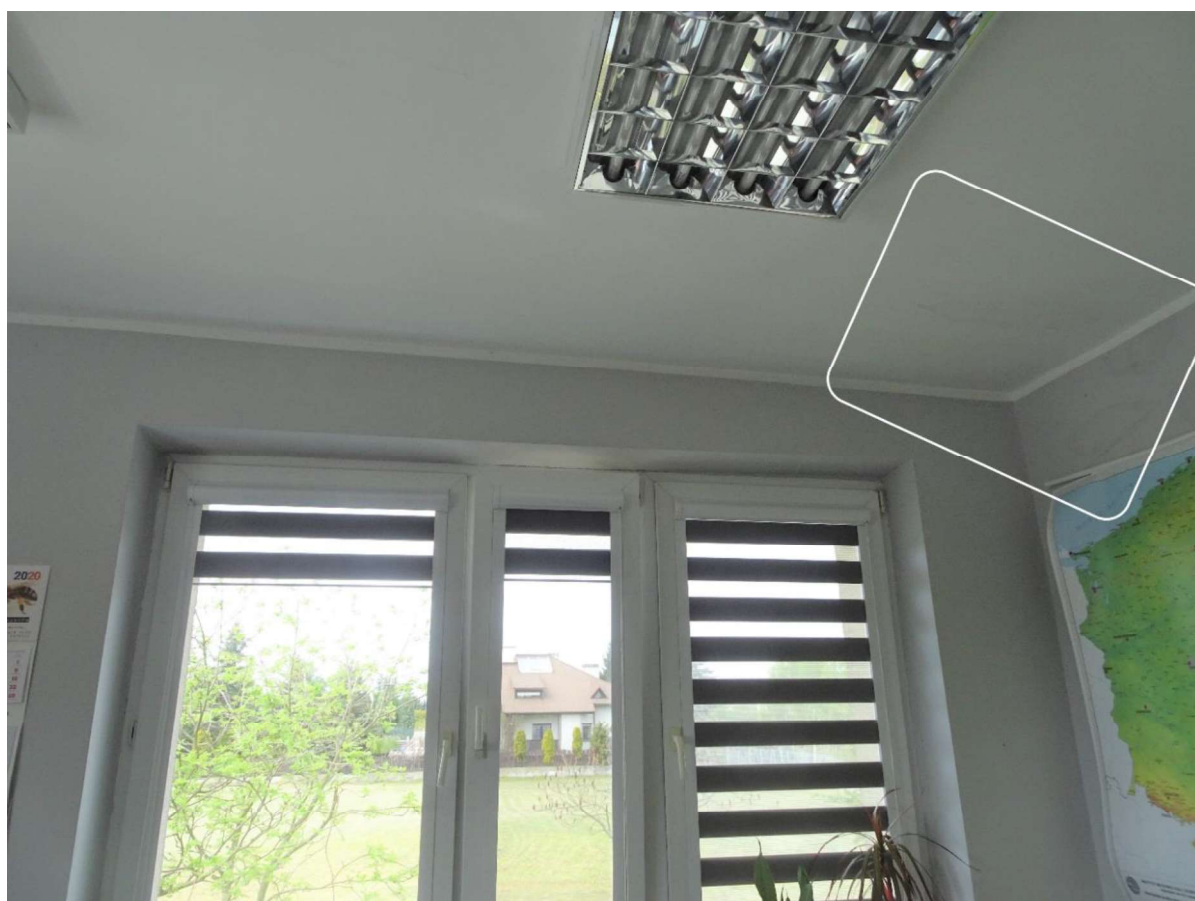
Rys. 20. Zawilgocenie narożnika w pomieszczeniu obserwatora.
