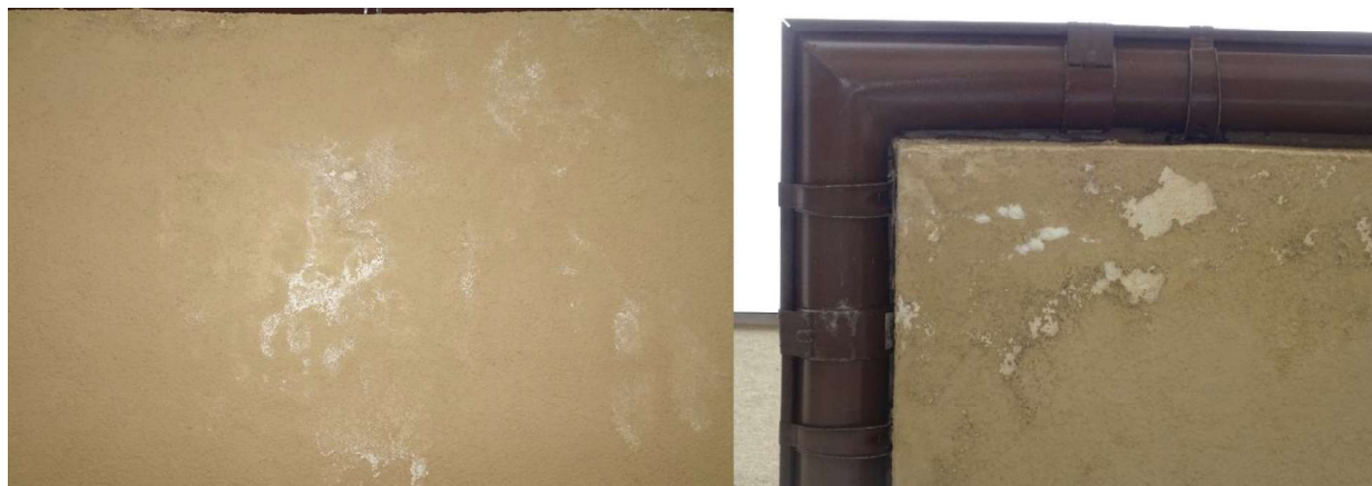
Rys. 6. Wykwity soli wapiennych na spodzie płyty balkonu.
