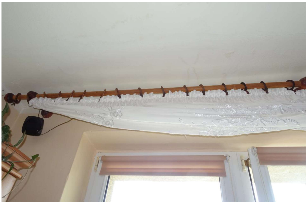
Rys. 15. Zawilgocenie stropu przy ścianie zewnętrznej w pomieszczeniu mieszkalnym. Ślady zawilgocenia widoczne są w paśmie 40 cm wzdłuż krawędzi stropu.
