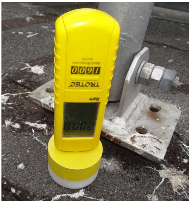
Rys. 26. Miejsowe zawilgocenie warstw bezpośrednio pod papą dachową w miejscu przejść konstrukcji wsporczych.
