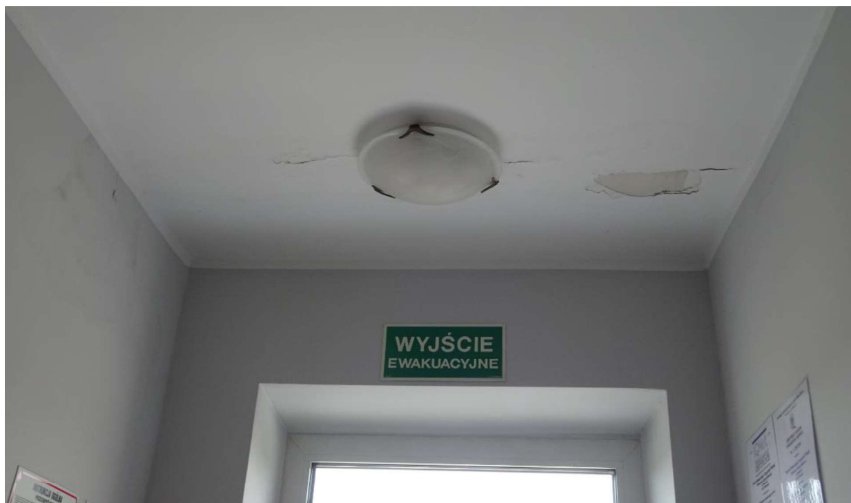
Rys. 19. Spękania i zawilgocenia tynku na stropie oraz na ścianach w korytarzu przy wejściu do budynku.
