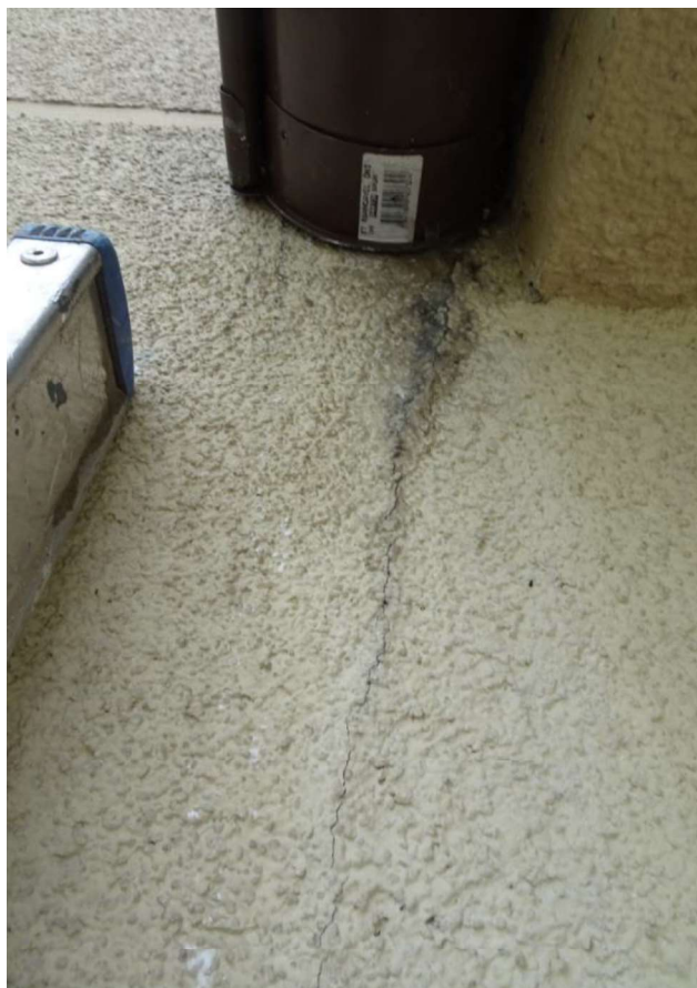
Rys. 9. Zaciek i pęknięcie tynku spowodowane penetracją wody w miejscu przejścia obróbki blacharskiej przez elewację.
