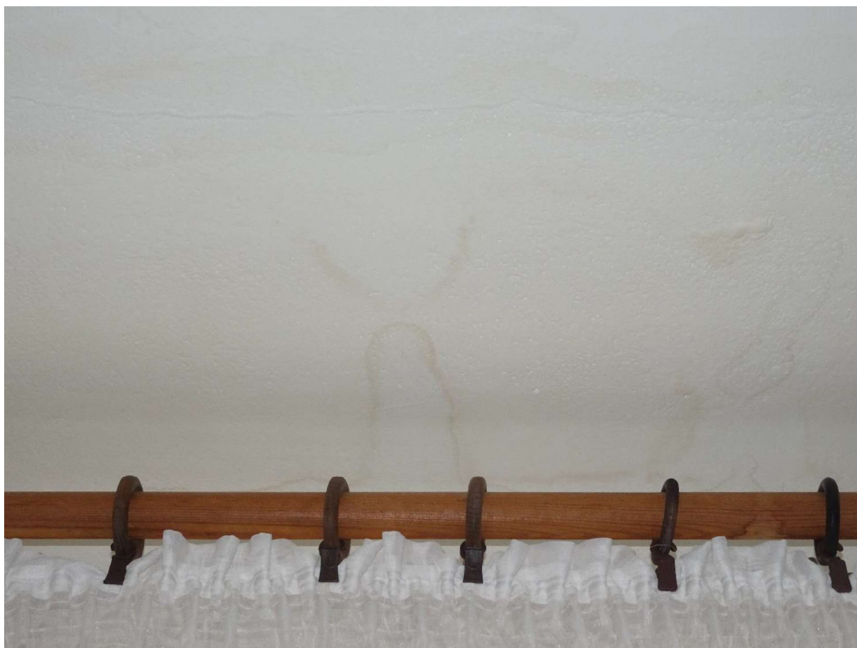
Rys. 16. Ślady zawilgocenia stropu nad oknem przy zachodniej ścianie zewnętrznej.
