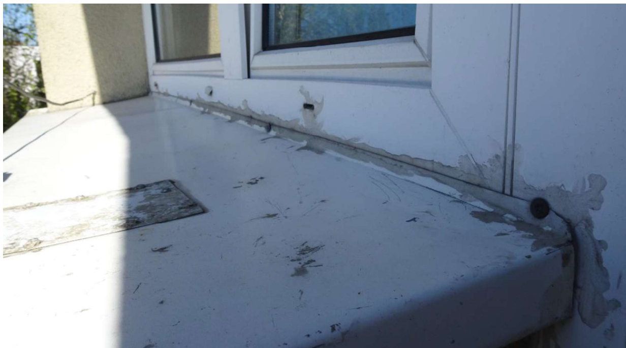
Rys. 13. Błędny montaż parapetu. Nieszczelności występują wzdłuż ramy okiennej oraz przy ościeżnicy.
