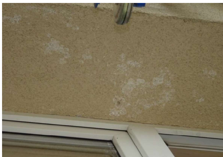
Rys. 8. Odspojenie farby na ościeżu okna. Spękania elewacji w miejscu styku z ramą okienną.
