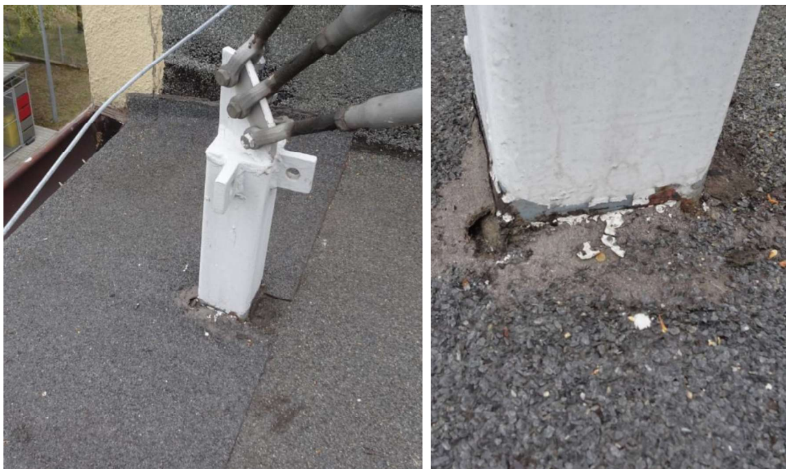
Rys. 23. Brak izolacji przeciwwodnej w miejscu przejść konstrukcji wsporczych urządzeń technicznych. Widoczne ślady uszkodzenia papy wierzchniej.
