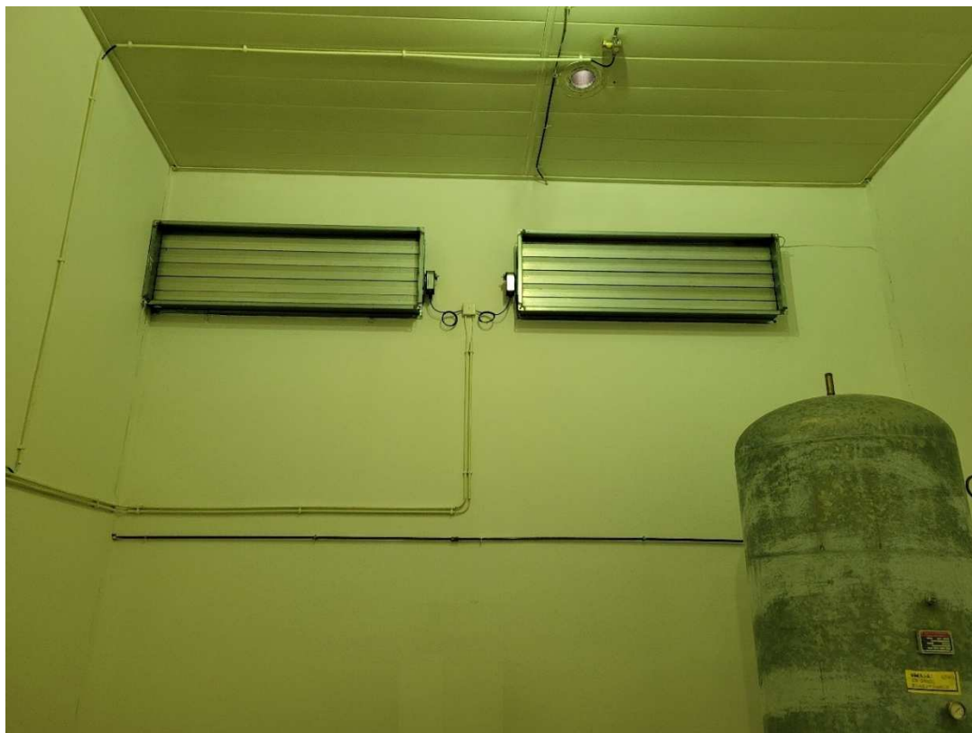
foto. nr 8 – widok na kłapy wentylacyjne oraz instalacje elektryczne
